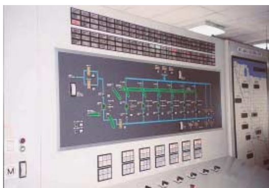
サリナ・タムリンポンプ場内の コントロールパネル
