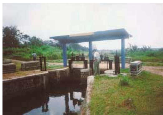
二次水路水門
