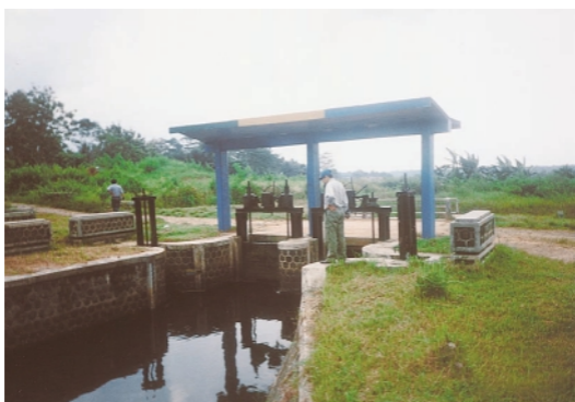
第1次水路水門
