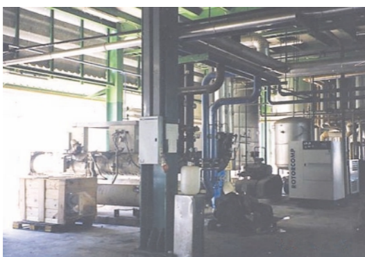
バルブ工場（パトンタニ地区）
