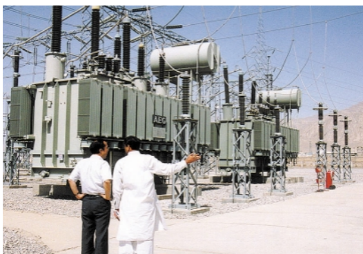
インダストリアル 変電所
