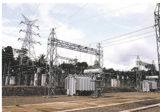
アビッサウエラ変電所
