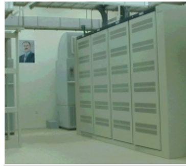
設置された交換機
