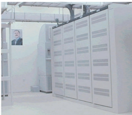
設置された交換機
