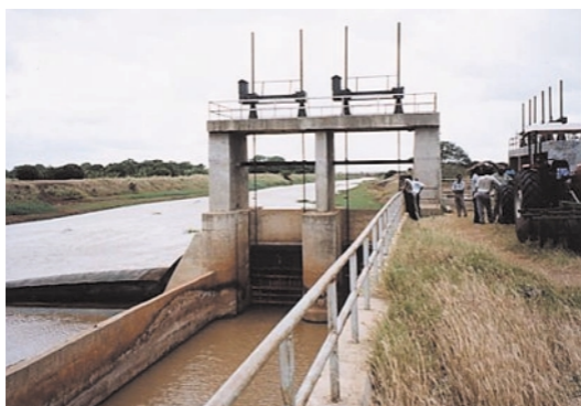
タナ・デルタ灌漑 サイロニ頭首工
