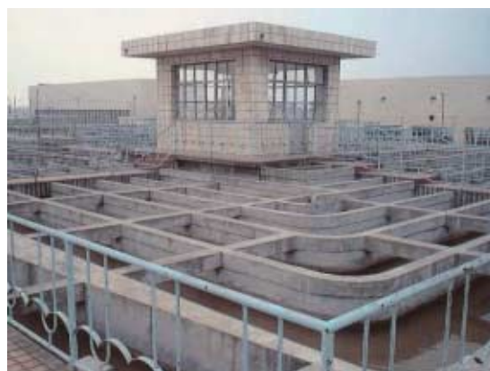
緩速濾過槽（南京）
