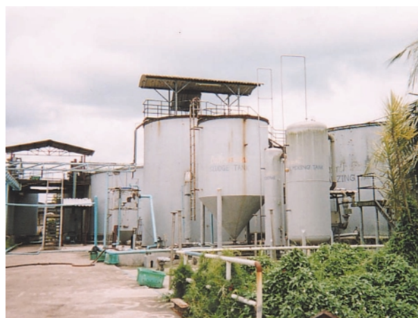
食品加工工場での排水処理装置
