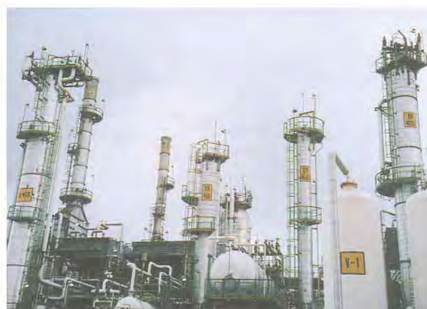
②：トウーラ製油所HDD装置
