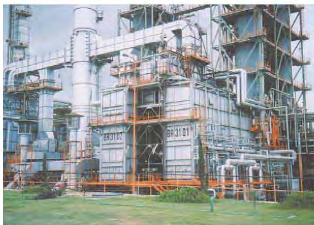
導入設備①：トウーラ製油所HDR装置導入設備
