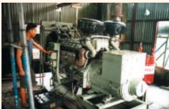
本事業により設置した小型ディーゼル発電機
