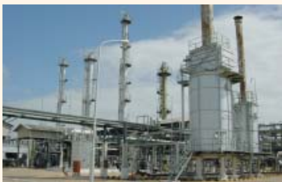
本事業により建設されたLPG回収プラント
