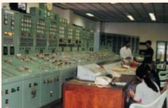
発電所コントロールルーム
