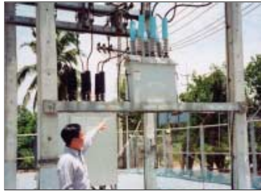
サイト写真：アントン第1変電所
