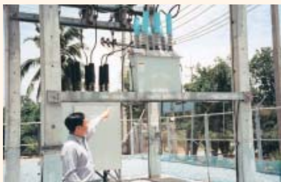
本事業により設置された変圧器
