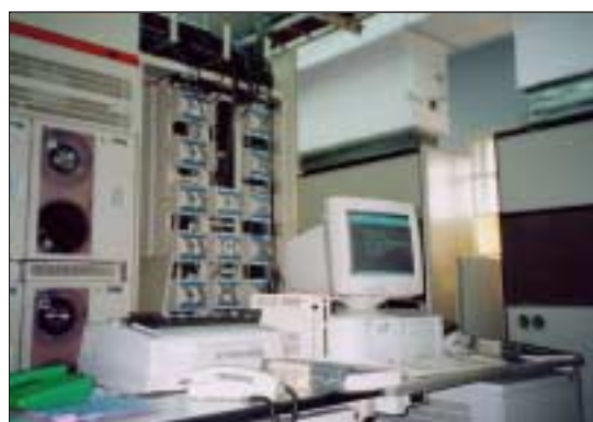
サイト写真：ダッカ市 Sher-e-Bangla Nagar 局 電話交換機
