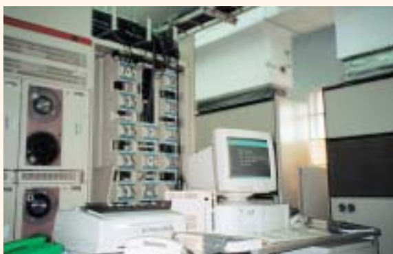
本事業により増設された電話交換局
