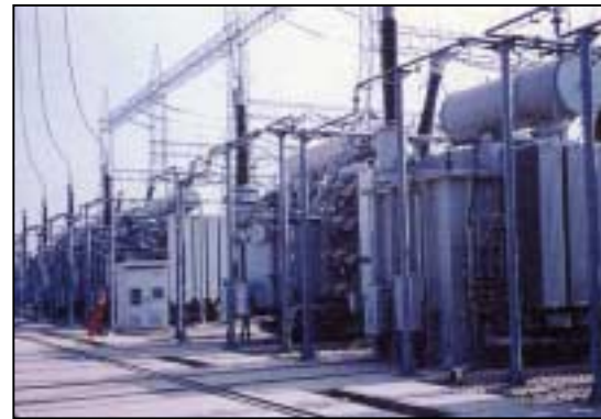
本事業により整備されたムルタン変電所
