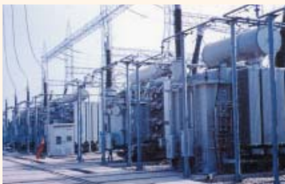
本事業により設置した変圧器（ムルタン変電所）
