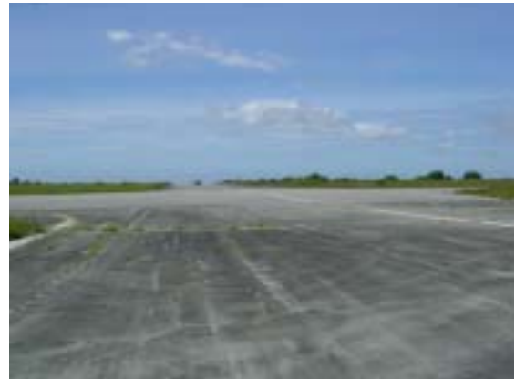
二次滑走路の亀裂
