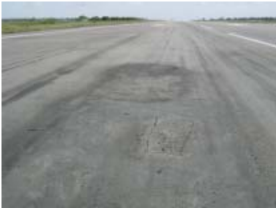
主滑走路の亀裂
