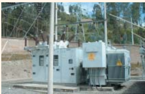
本事業により建設された二次変電所
