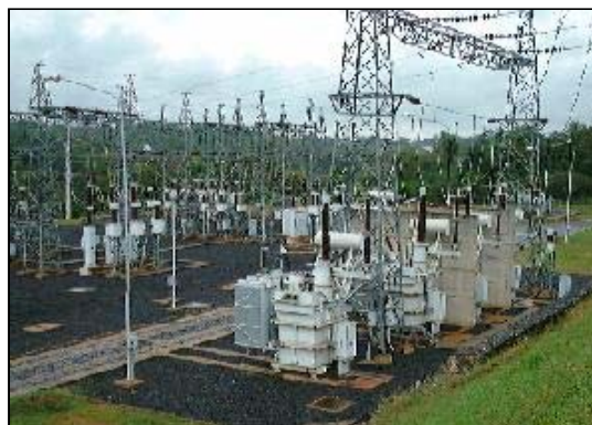
サイト写真：リンピオ 変電所
