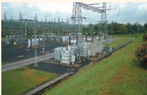
本事業により建設されたリンピオ変電所
