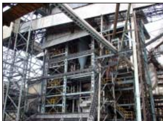
流動床ボイラー
