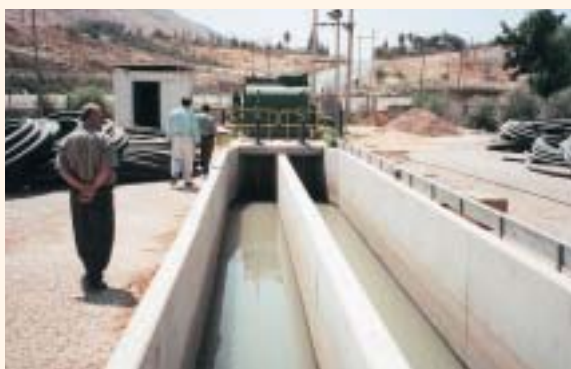
本事業にて建設されたポンプ場
