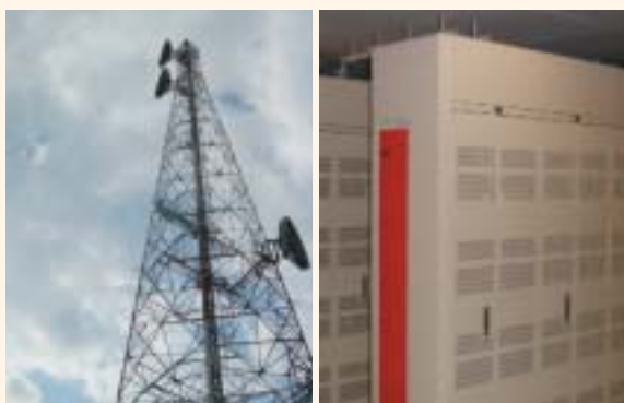
本事業にて整備されたデジタル交換機と通信塔
