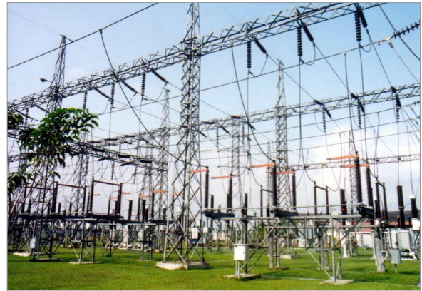
マドゥラ島ギリ・ティムール変電所
