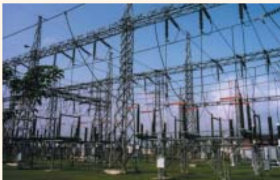
本事業により建設されたギリチムール変電所
