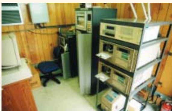
本事業により整備された環境測定機器
