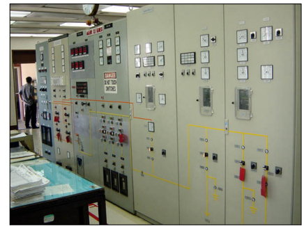
ラオアグ変電所の制御室
