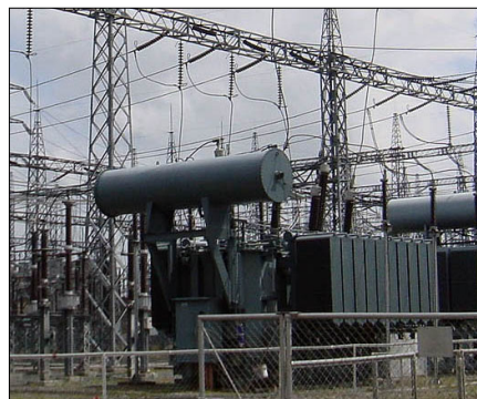
ダスマリナスの 300 MVA 変圧器
