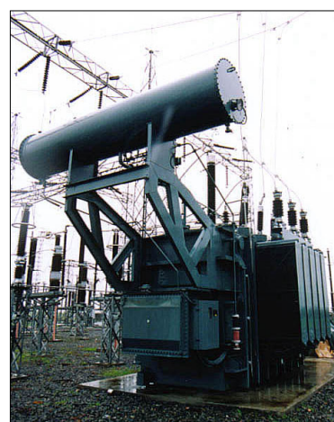
設置された 50 MVA 変圧器
