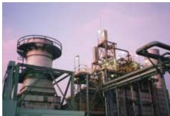
サイト写真：ガスタービン2号機
