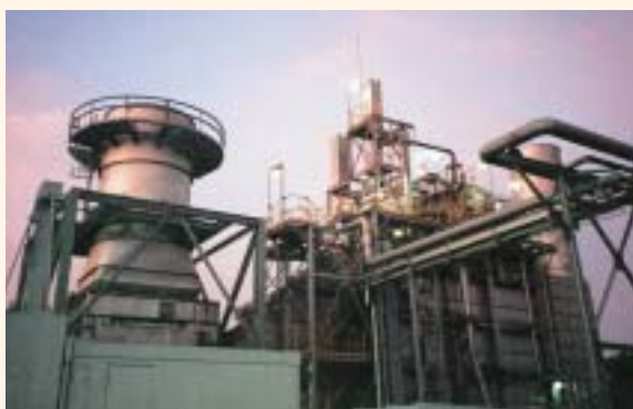
完成したコンバインド・サイクル発電所
