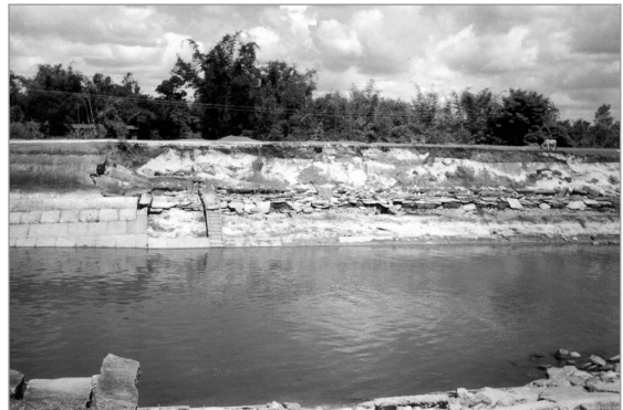
写真- 1: MMC の護岸崩壊の様子
