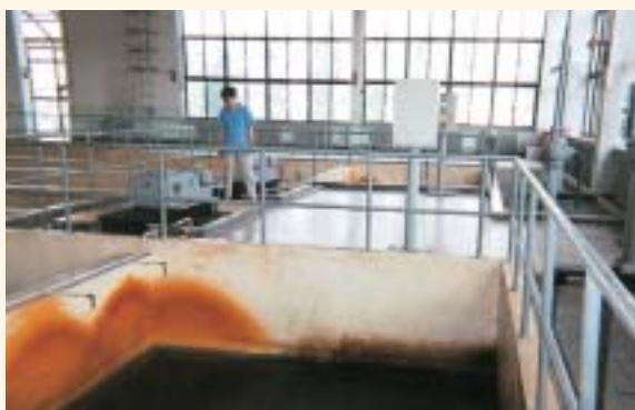
本事業により建設された浄水場施設
