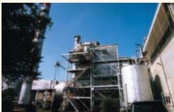
プリオク発電所3号機
