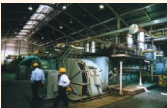
本事業により設置されたディーゼル発電機
