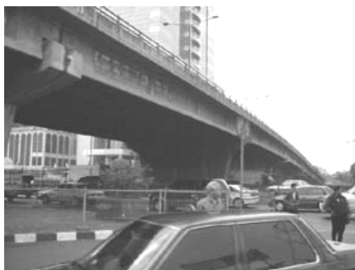
都市道路 (アングレックネリムルニ フライオーバー(ジャカルタ))
