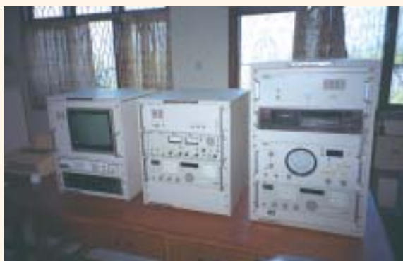
整備された電波監視機器
