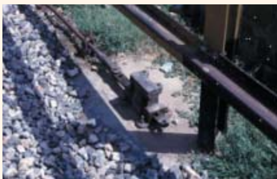
本事業により導入された軌道回路
