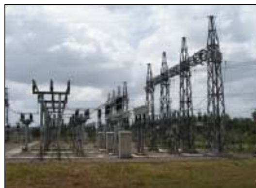
サイト写真：Matara 変電所
