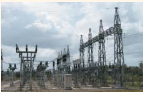
本事業により新設されたマタラ変電所
