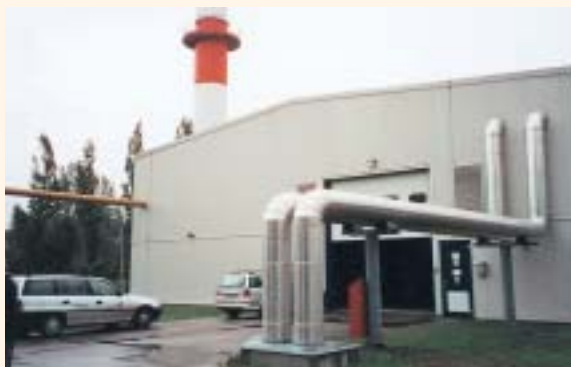
本事業により新設された熱供給システム（ヴァルパロタ）
