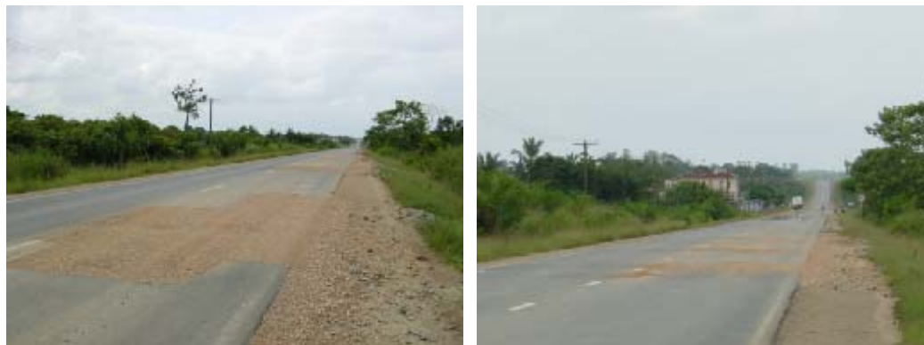
道路損壊状況
