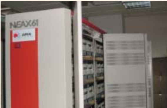
アクラ電話交換局の新設交換機
