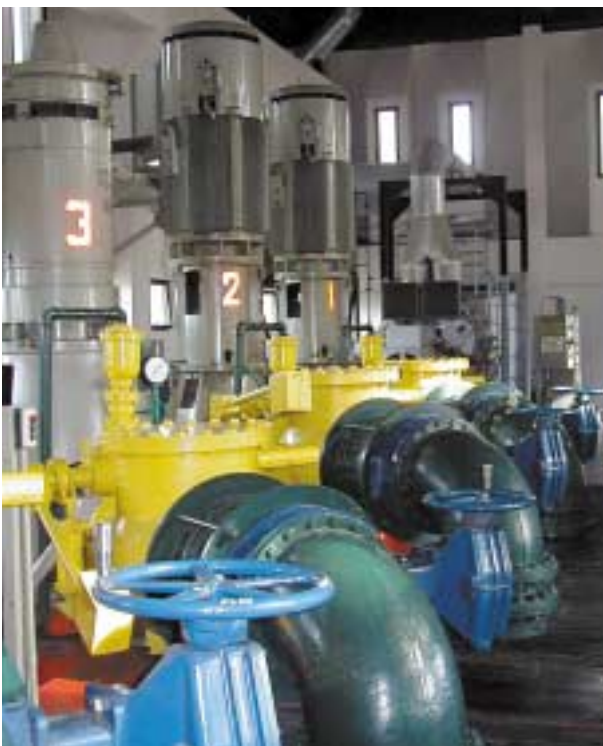
円借款にて設置されたポンプ施設
