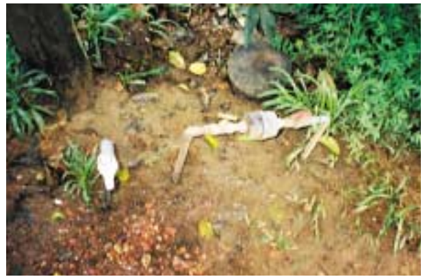
各家庭に設置された水道メーター
