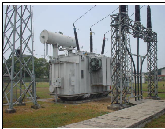
本事業により設置された変圧器
