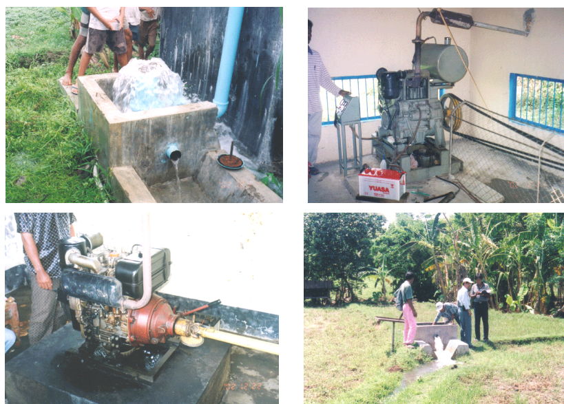
図8 本事業で導入されたポンプと配水桝から湧き出る水
